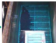
Filtration charbons actifs
